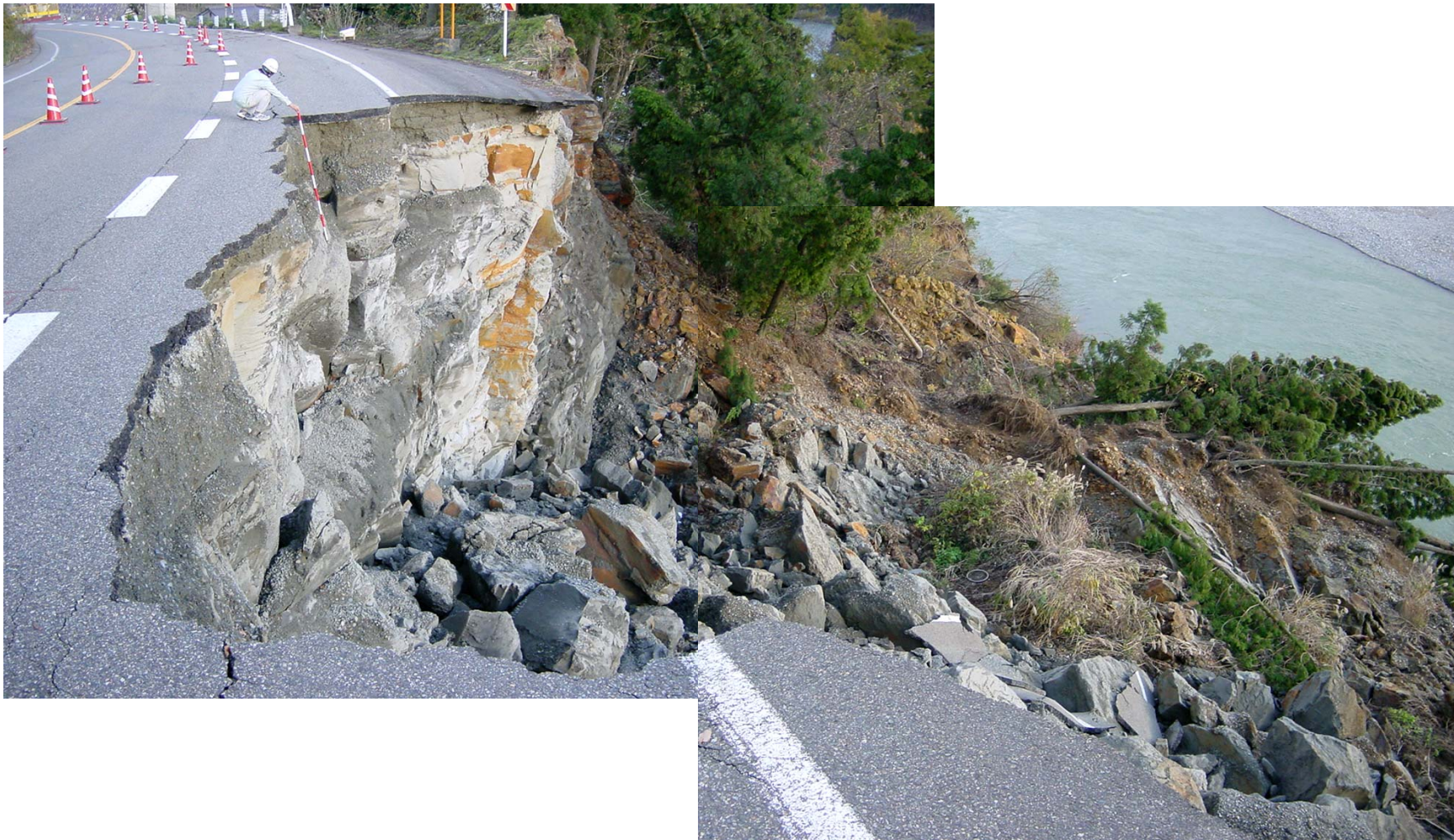
前出の現場, 反対側から撮影したもの。 崩壊土砂および倒木は、信濃川の流路を半分程度塞いでいる。 滑落崖はやや拝み勾配(ほぼ走向と直交方向であるため)。オーバーハングしている。 スケール: ポールの長さは2m。
