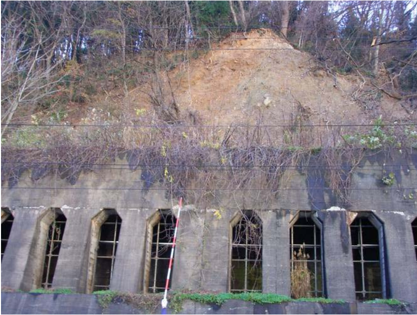
JR上越線 榎トンネル下り線 長岡側スノーシェッド (コンクリート柱)の被災状況。
