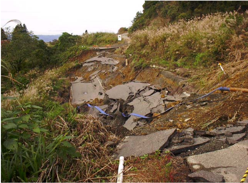
主要地方道 小千谷川口大和線 (川口町 震央周辺)
