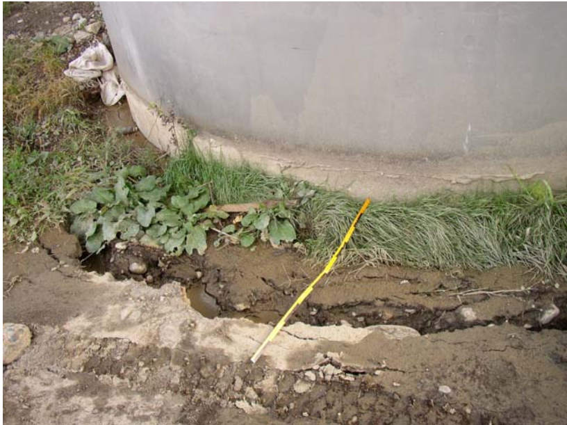
長岡市内上越新幹線高架橋橋脚 橋脚基礎部分の液状化跡と埋め戻し部分の沈下状況。
