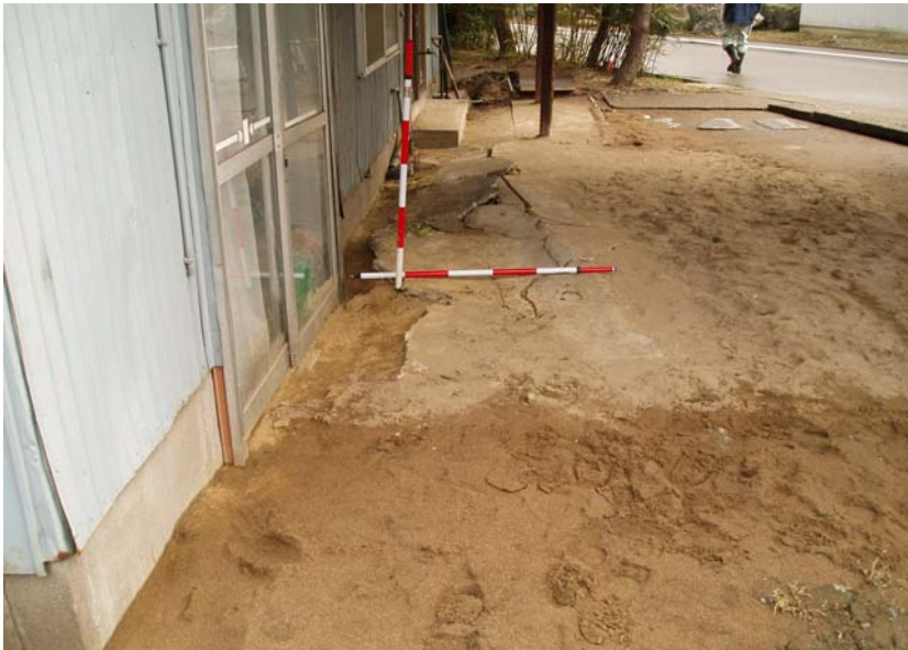
液状化による噴砂現象(柏崎市内)
