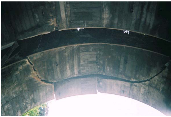
坑口内部から坑門天端方向を撮影。 坑門の継目部分(?)が周方向に開口し、天端コンクリートには開口亀裂が生じている。 コンクリート塊として下方へ落下しそう。
