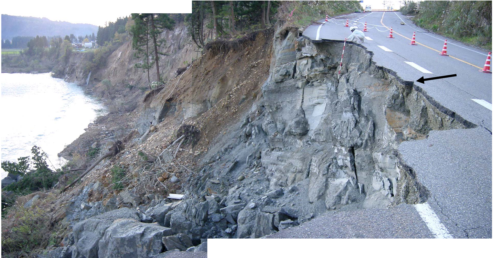
主要地方道川口塩殿線 路肩の崩壊。 蛇行しながら流下する信濃川の攻撃側斜面で発生している。河川沿いの斜面は表層崩壊し、未風化部分が剥き出しになっている。 矢印の方向は地層面の走向であり、地層面と直交する面から剥がれ落ちている。地山は緩み、節理面は開口している。 滑落崖からの湧水は認められない。 地質は、中新統に属する川口層。岩質は砂質泥岩と泥質砂岩との互層。 スケール:ポールの長さは2m。
