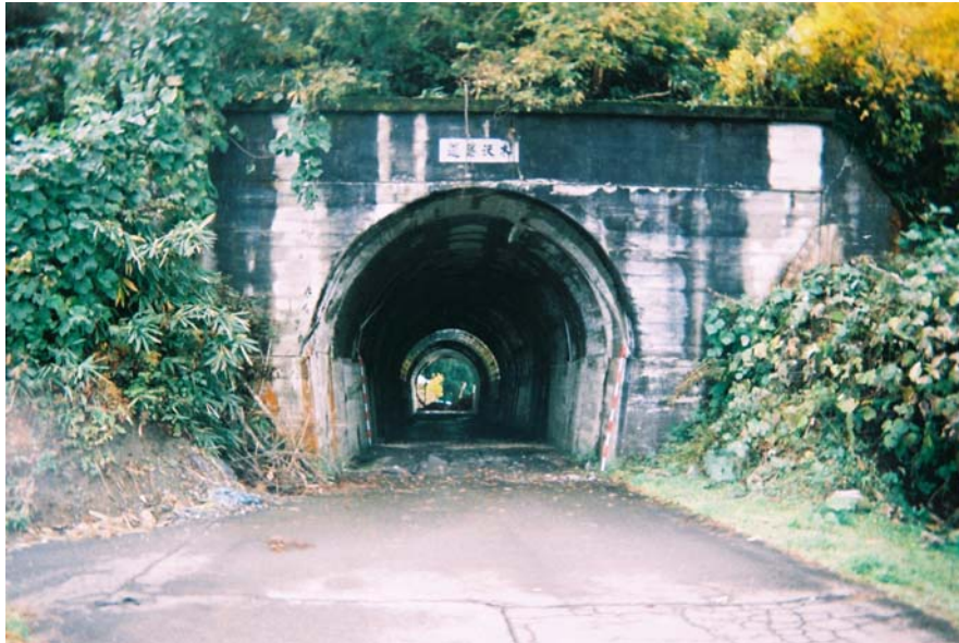
主要地方道小千谷川口大和線 木沢隧道(旧道トンネル, 山古志村側) 坑口の被災状況
