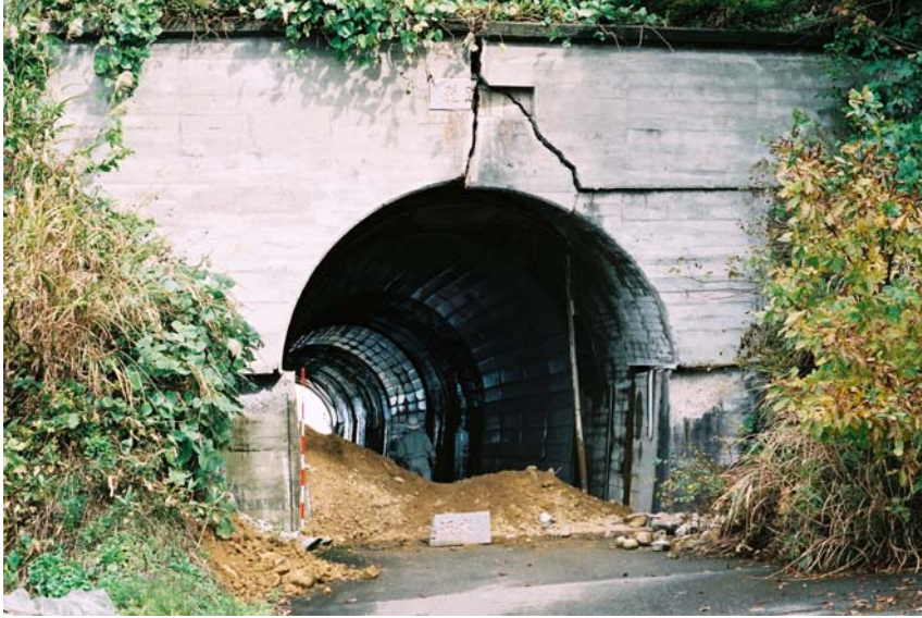
木沢隧道 川口町側(南側) 坑口の被災状況
