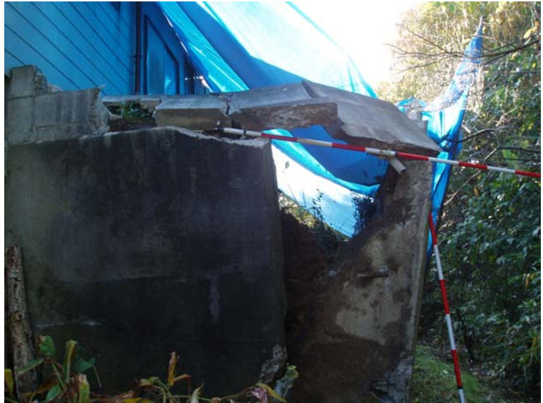
盛土部L型擁壁の変状(柏崎市)
