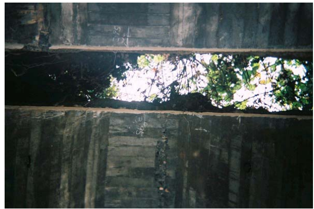
左写真の近接。 周方向に生じた継目の隙間幅は20cm程度。 トンネル内から天端方向を見上げると、隙間部分から空が見える。
