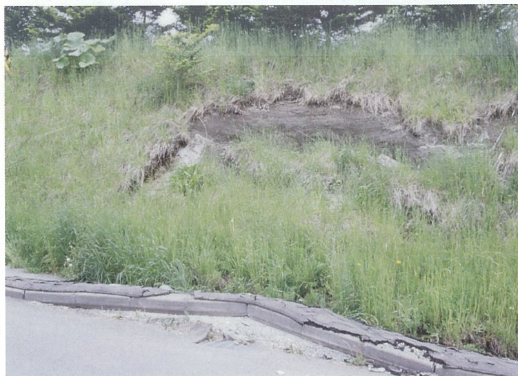
法面の植生がずり落ち、縁石が法面川へめり込んでいる (虻田町高砂)
