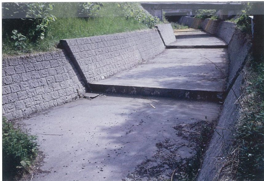
壮瞥温泉源田川上流 流路工が地殻変動により40cm程度の段差を生じている。変状は帯工の目地部に生じている(手前が上流側)。
