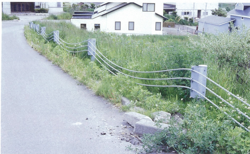
圧縮によるガードロープの緩み(虻田町高砂)
