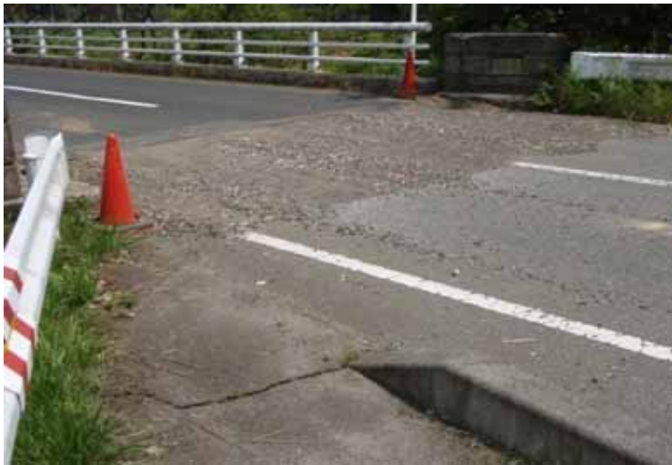
写真： 橋台背面の段差・クラック
