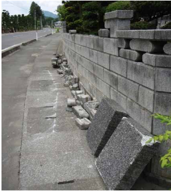
写真： ブロック塀の崩壊（鉄筋無し）
