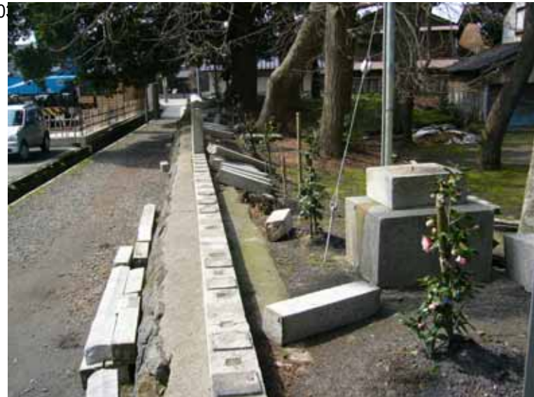
07 輪島市内変状-04
