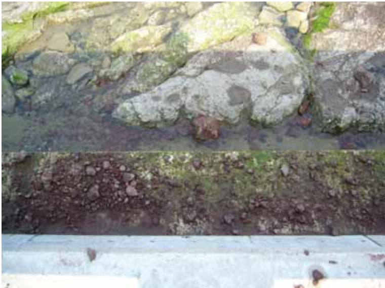
03 赤神法面崩壊-0
