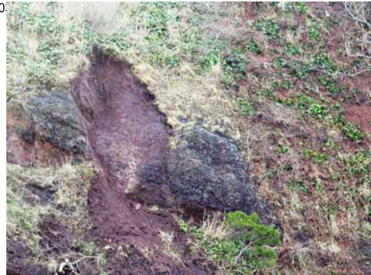
03 赤神法面崩壊-04
