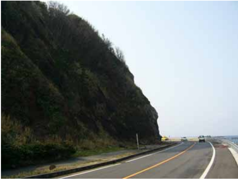
03 赤神法面崩壊-0
