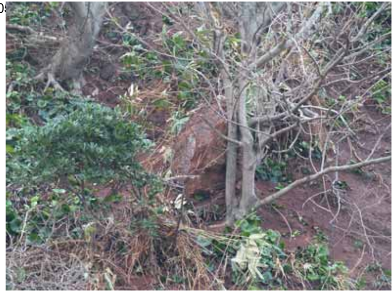
03 赤神法面崩壊-06
