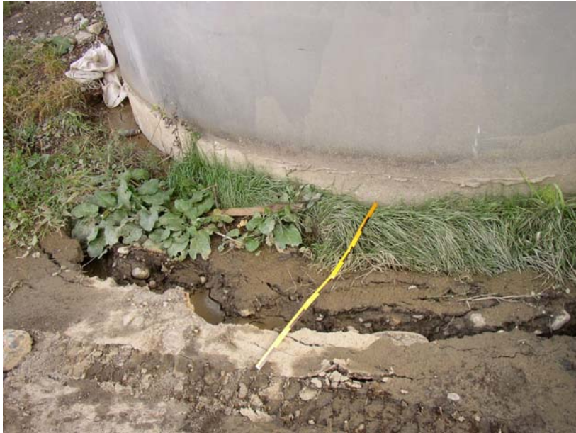
長岡市内上越新幹線高架橋橋脚 橋脚基礎部分の液状化跡と埋め 戻し部分の沈下状況。
