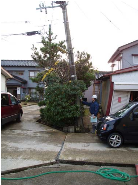
宅盤の流動化が生じ、写真右側に水平移動したため、約11° 傾斜した電柱（柏崎市内）
