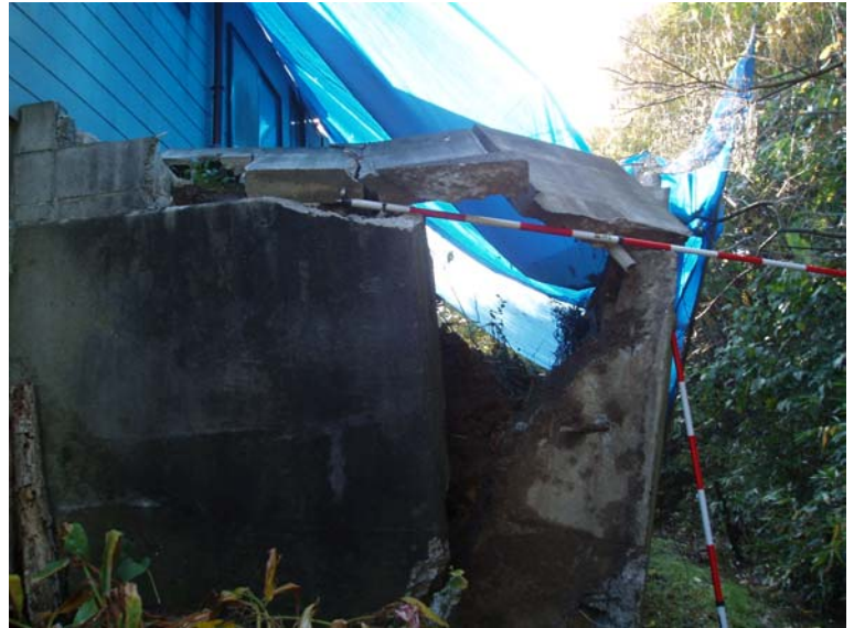
盛土部L型擁壁の変状（柏崎市）
