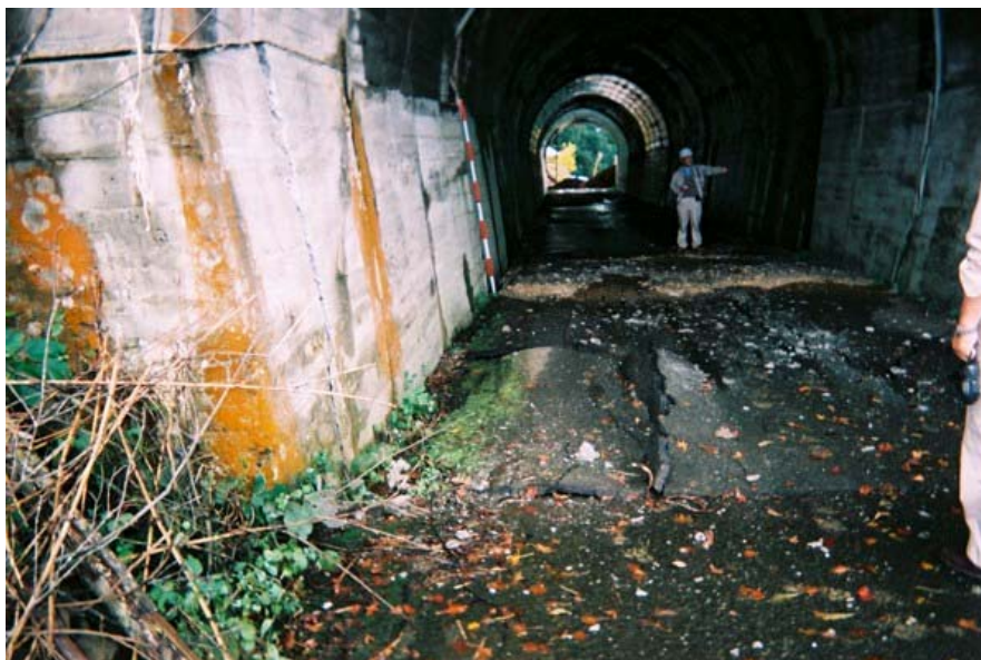
同上地点近景 路面状況
