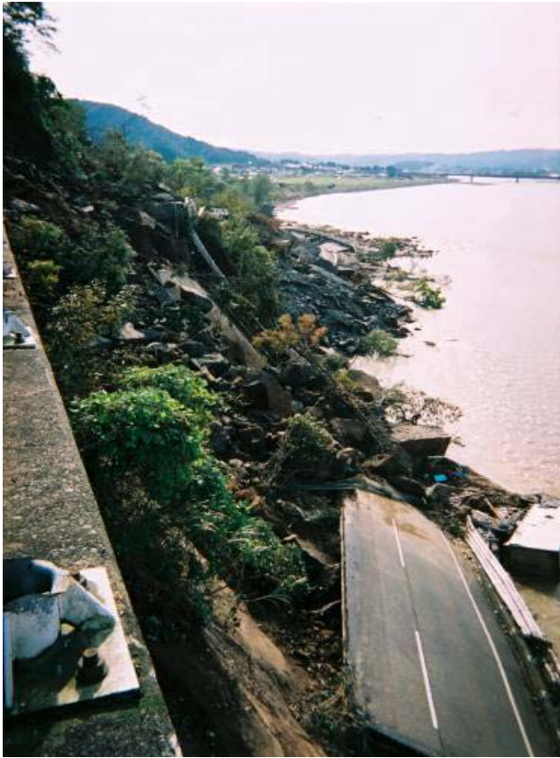
県道小千谷長岡線（JR上越線榎トンネル長岡側と並走）橋梁の被災（長岡市妙見町）
