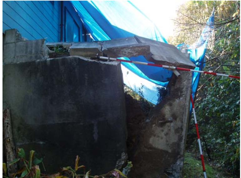
盛土部L型擁壁の変状(柏崎市)
