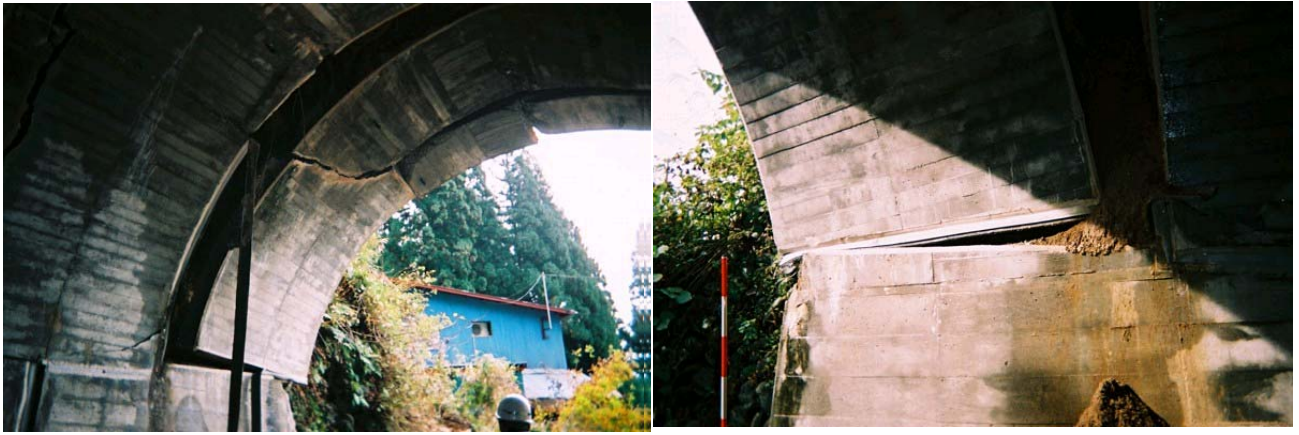
側壁部とアーチ部との境界部分に隙間が発生し、覆工背面の土砂がトンネル内に流入している。
